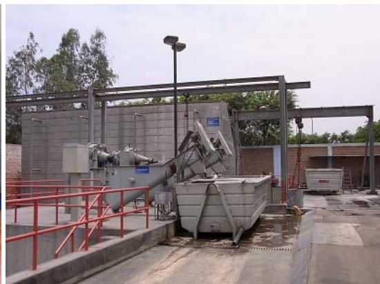
Pre-Treatment Plant (Punto A)
