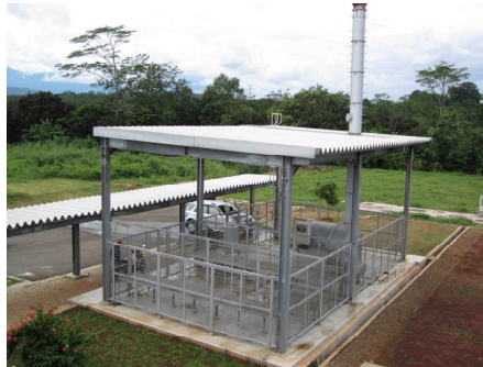
(Incinerator at the Subang DIC)
