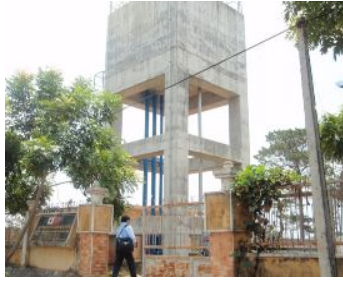
Elevated tank (Kong Tang)
