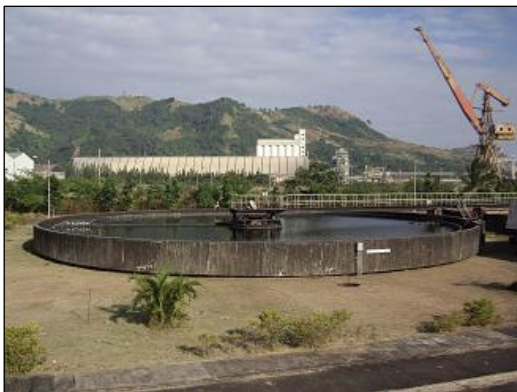
Sedimentation Tank (Bataan)
