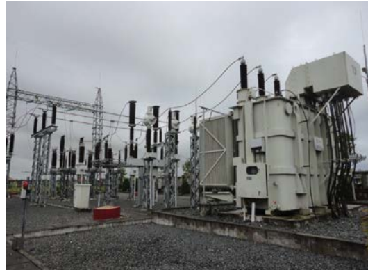
Hoa Khanh 2 Substation (Da Nang City)
