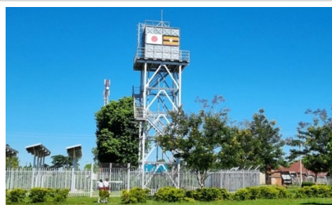
Elevated Water Tank (Kameke)
