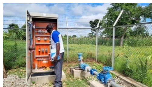
Water Intake Facility (Kasassira)
