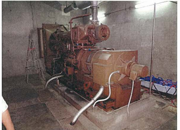
1984年に我が国の無償事業で調達された発電機。保守も完全で現在も稼働しているが容量が不足している。
