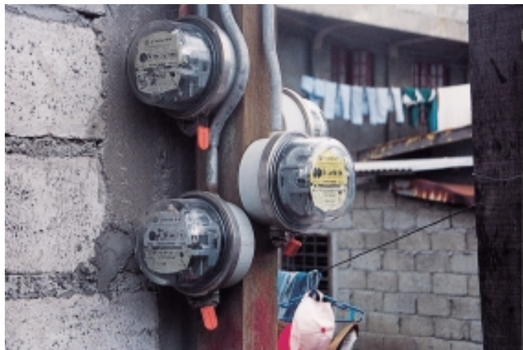
本事業によって取り付けられたメーター
