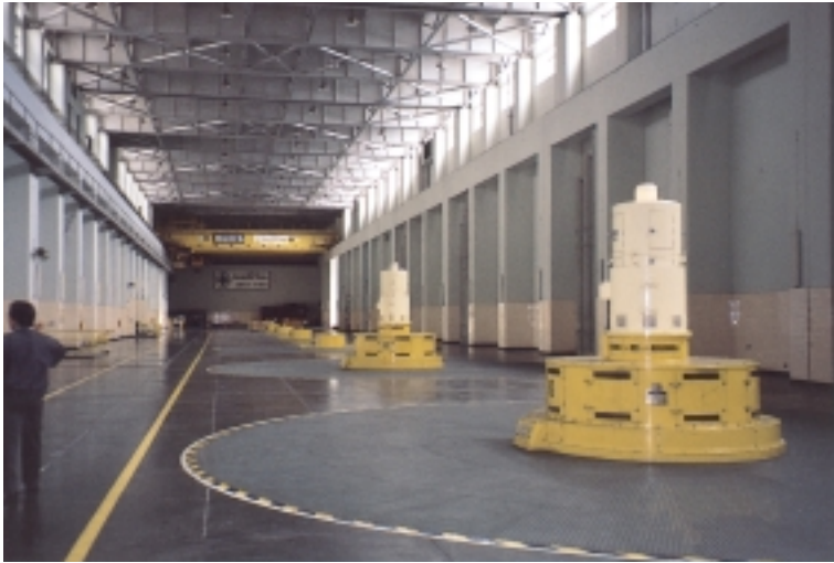
ブミボン発電所内
