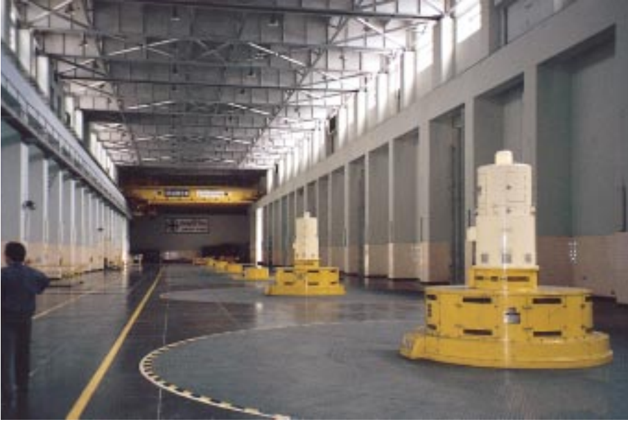
プミボン発電所内
