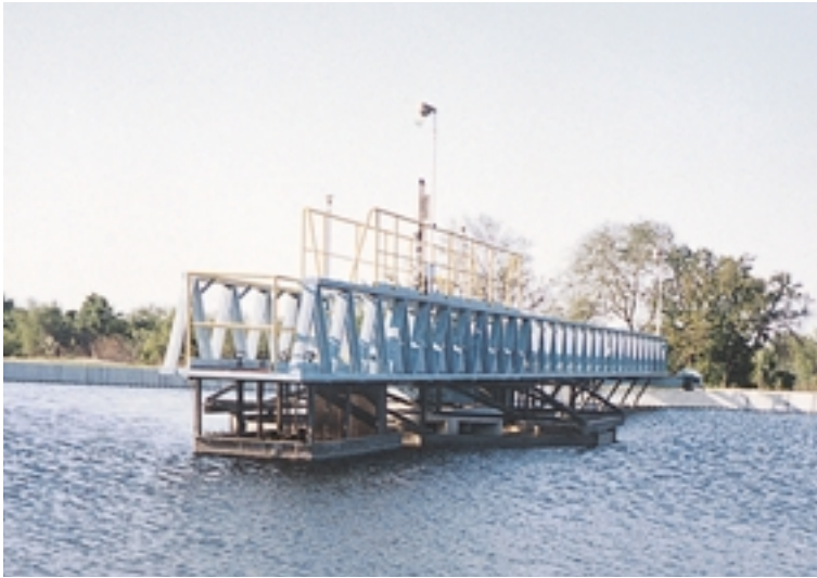
ノレステ下水処理場の二次沈殿施設
