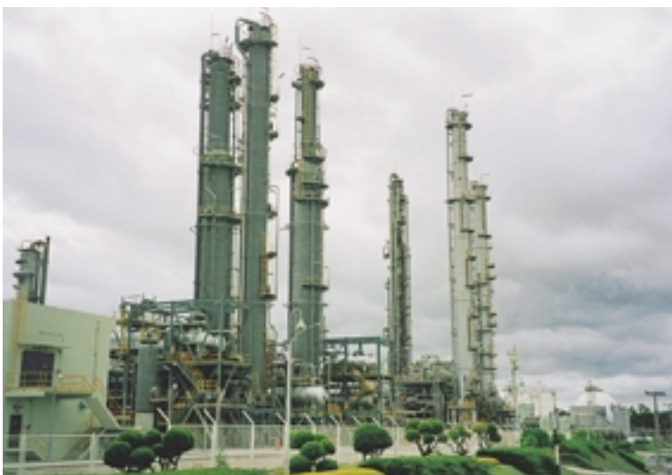
工業団地内の天然ガス分離プラント
