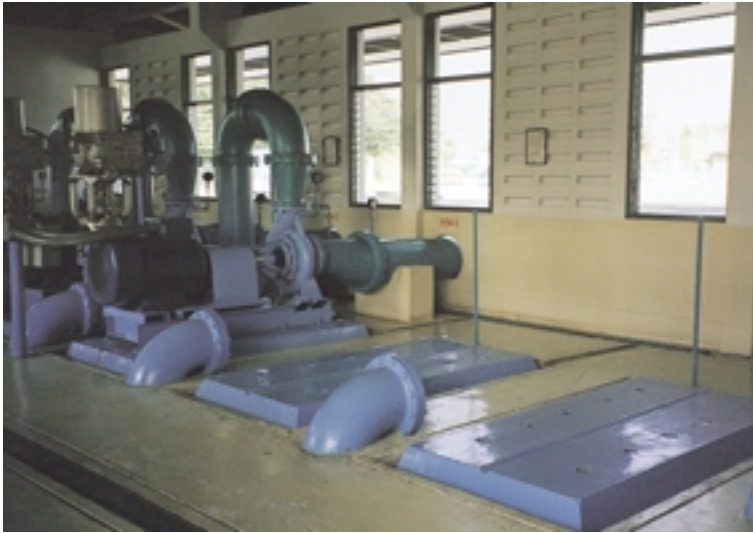
レムチャバン イースト・ウォーター社事務所敷地内 ポンプ室
