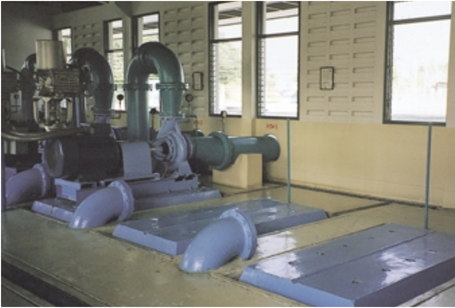
レムチャバン イースト・ウォーター社事務所敷地内 ポンプ室
