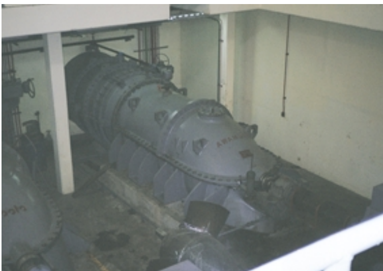
本事業により増設された大型ポンプ
