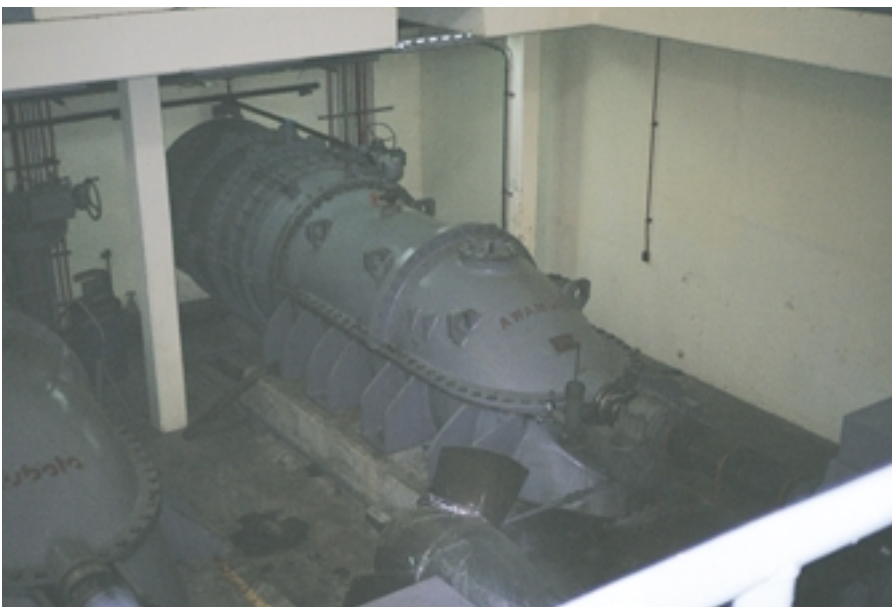
本事業により増設された大型ポンプ
