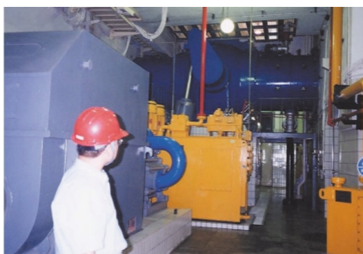
北京十三陵揚水発電所内部
