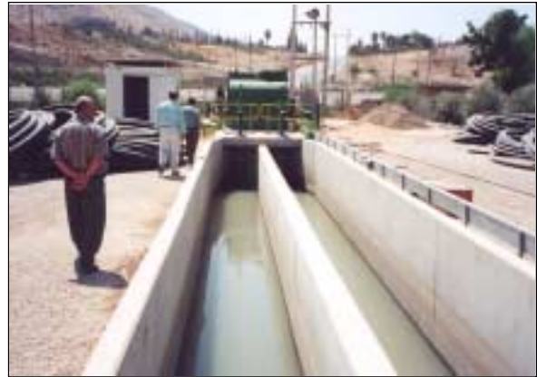
サイト写真：第2ポンプ場
