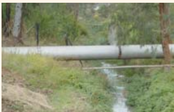
本事業にて建設された送水パイプライン
