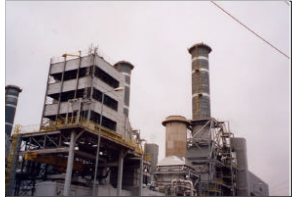
サイト写真：コンバインド・サイクル発電所
