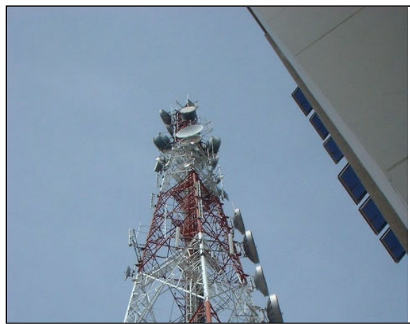
サイト写真：7174局の伝送設備
