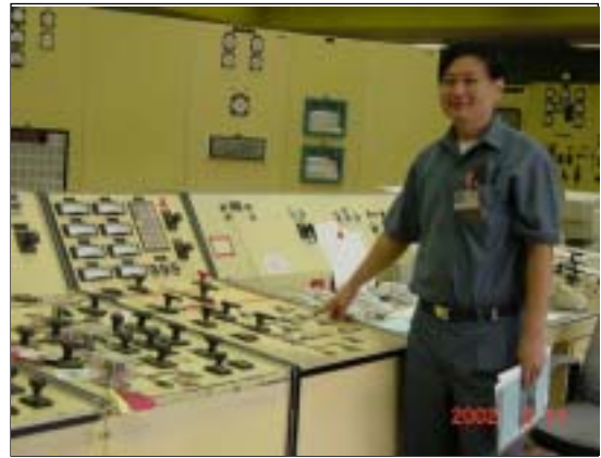
サイト写真：第4号発電機の制御盤
