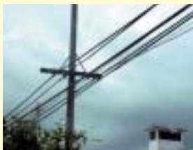
トラット県のケーブル （真中の太いケーブルが本事業対象）
