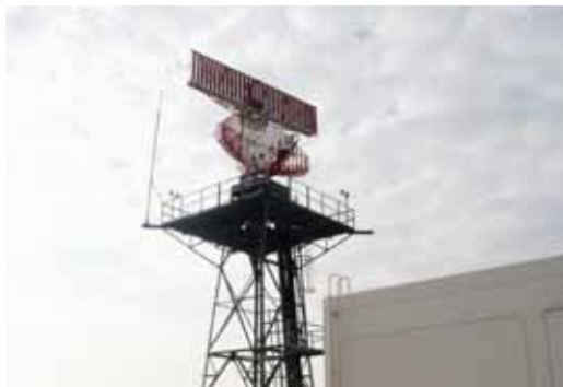
ウルゲンチ空港レーダー
