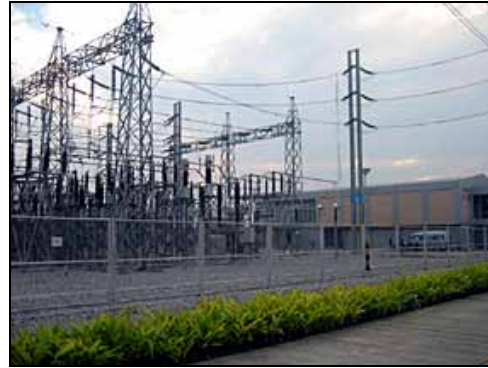
本事業により建設されたメーラオ変電所
