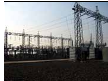
図 2 レムチャパン変電所
