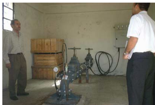
取水ポンプ場内部（清掃されており、十分維 持管理がなされている）
