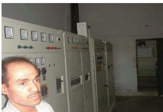
シリアが設置した配電盤（奥の部屋に送水ポ ンプが設置されている。シリアが作成した運 営管理マニュアルが整備されている。）
