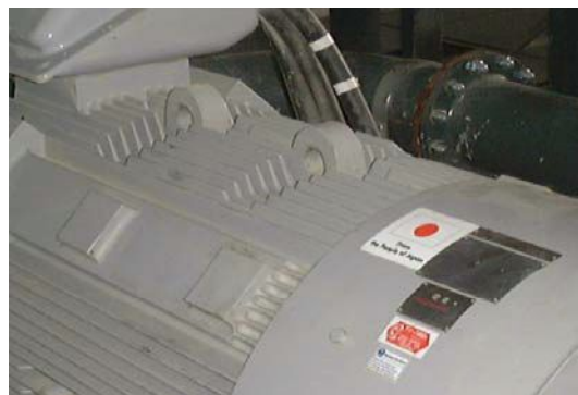
送水ポンプ（特段劣化は見あたらず、十分維持管理がなされている。）
