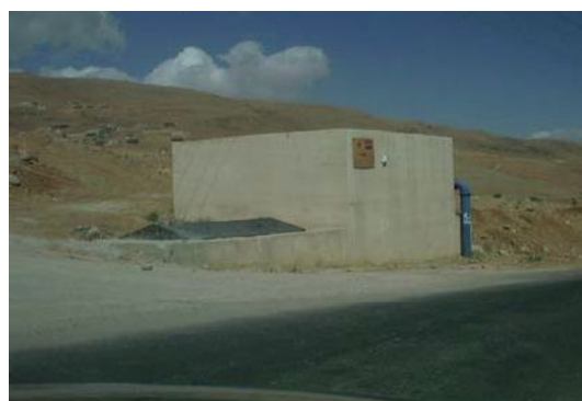
ヘルモン山山頂から給水対象地区へ送水する ための減圧槽
