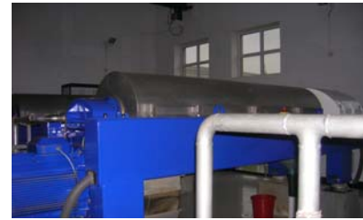
図3 汚泥対策施設
