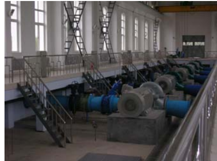
本事業によって整備されたポンプ場
