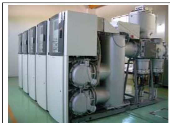
サイト写真：本事業により設置された変電設備
