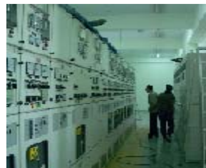
写真 1 : 変電所制御板
