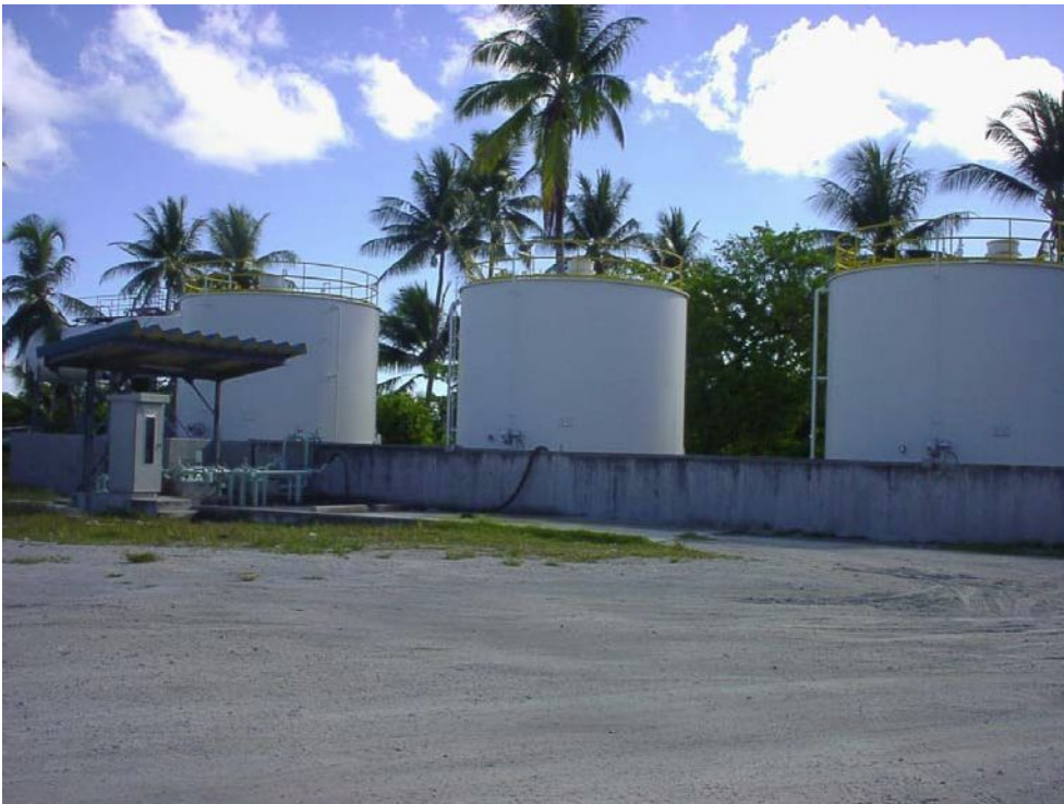
発電用油タンク
