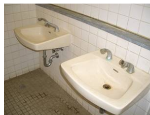
水道の蛇口が破損し、手洗用洗剤容器が紛失している。
