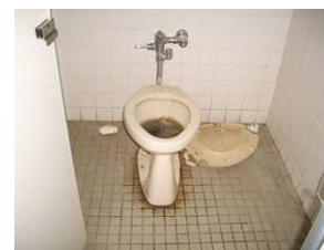
故障したままの便器(悪臭を放し、衛生上問題である。)
