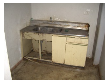
ターミナルビル内の老朽化した流し台
