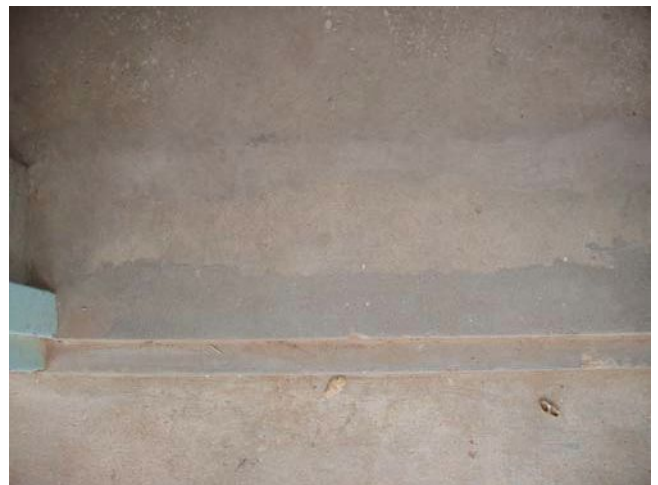
事後点検で修理した床のヒビ
