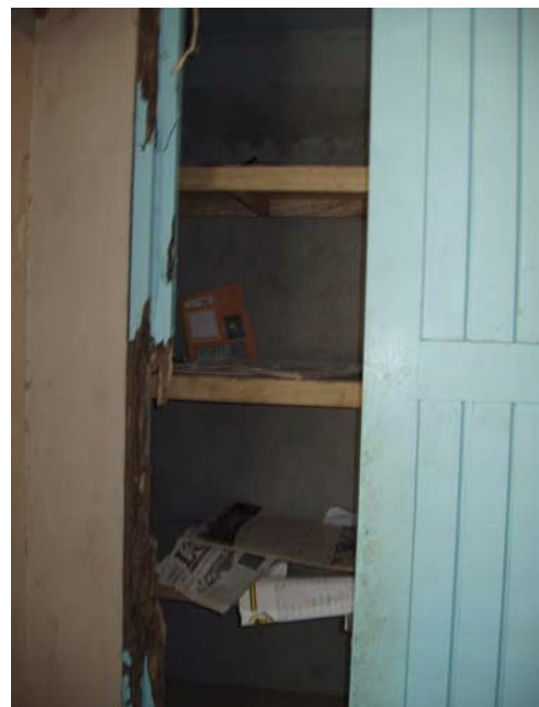
シロアリの発生した用具入れ
