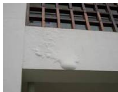
塗装剥離の原因となっている水泡が発生している箇所 (管理棟外壁)
