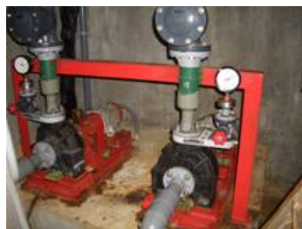
海水の送水ポンプ(固定土台は錆止めの塗装処理が行なわれている。)
