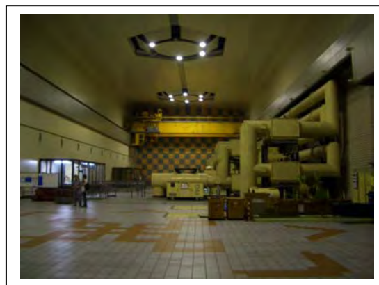
発電機フロア
