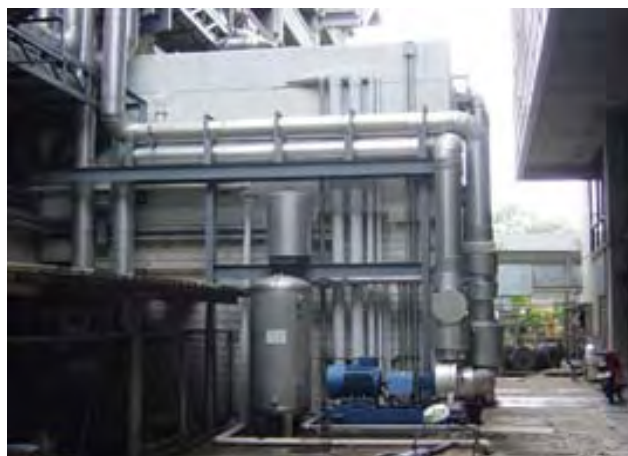
サイト写真：EGAT内に設置された蓄熱機器
