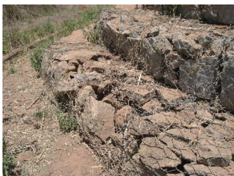
法面防護工の蛇籠（フェンスが破られ石材が盗まれている）
