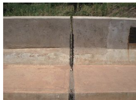
欄干（接合資部分のゴムが取れている）
