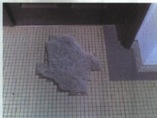
18. 廊下のタイル剥がれ
