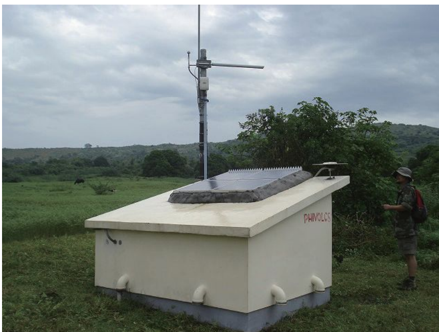
写真2：タール火山集中観測網カラウイト無人観測点 (施設屋根部のソーラーパネルが、コンクリートにて強固に 設置されている)
