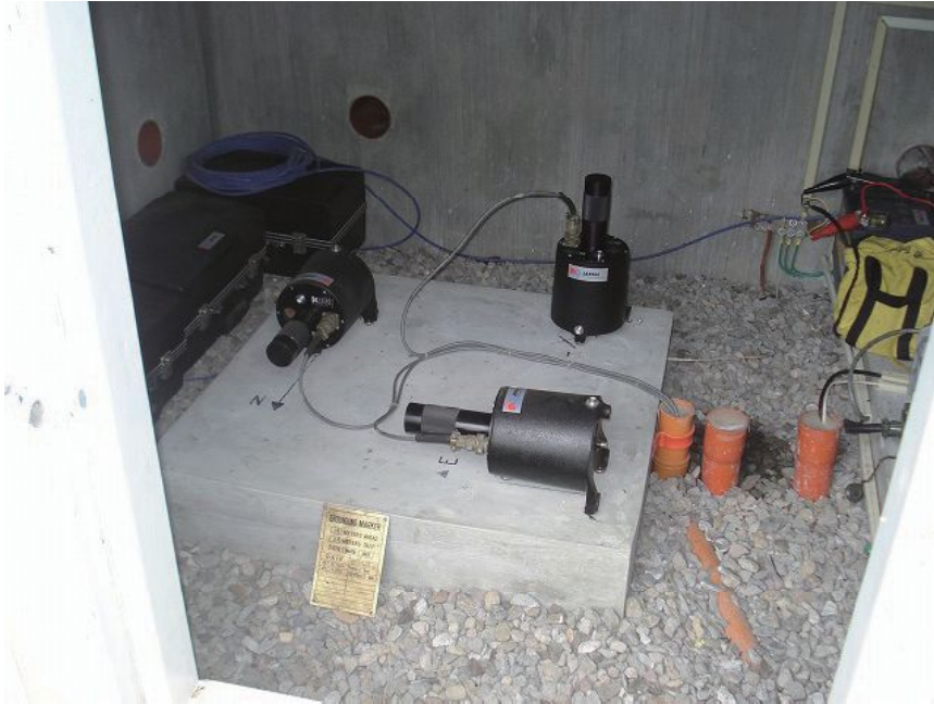
写真3：建物内部に設置されている短周期地震計
