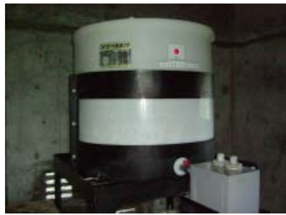
配水池内塩素注入設備
