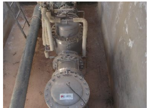
供与機材の状況
