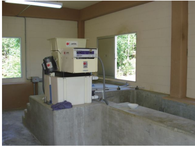
モラレス浄水場の凝集剤注入装置
