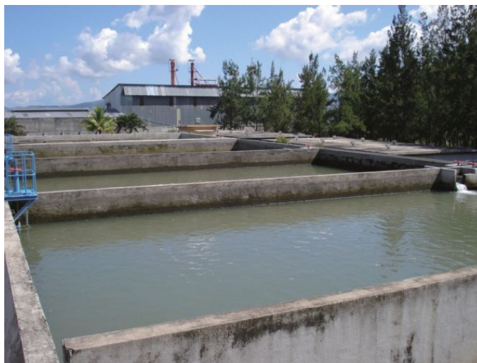
エスキプラス浄水場の緩速ろ過池
