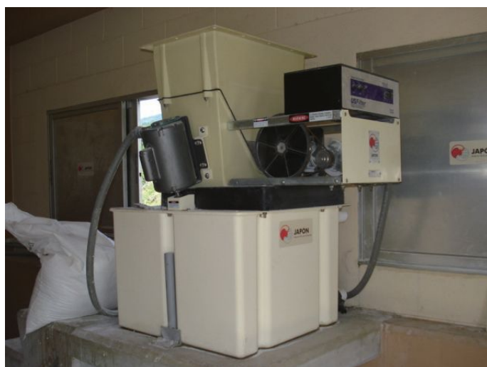
フティアパ浄水場の凝集剤注入装置
