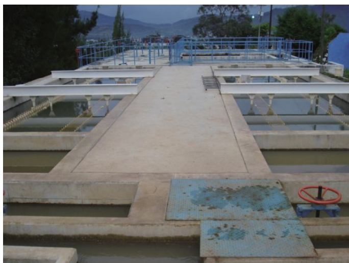
ハラパ浄水場の沈殿池(手前)及び急速ろ過池(左側奥)
