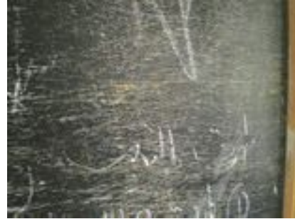
一部黒板の劣化
