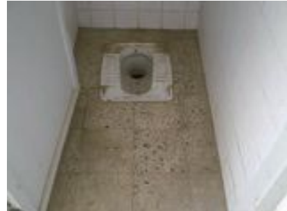
便所 (水の蛇口がない)
