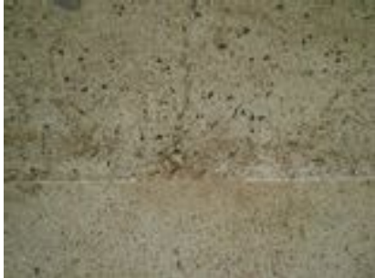
一部階段の破損
