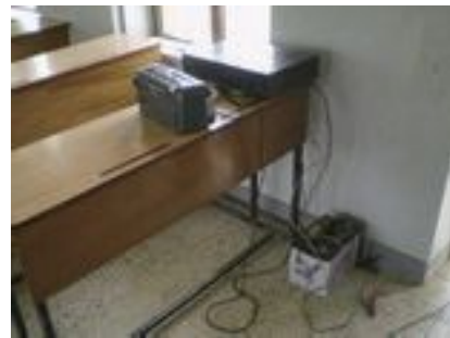
バッテリーの活用 (電気がないため)
