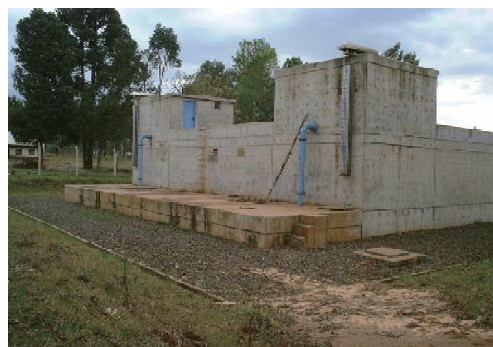
○配水施設関連2(配水タンク)
