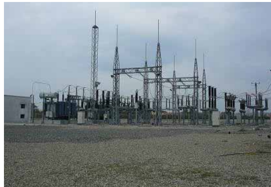
ティラナ変電所
