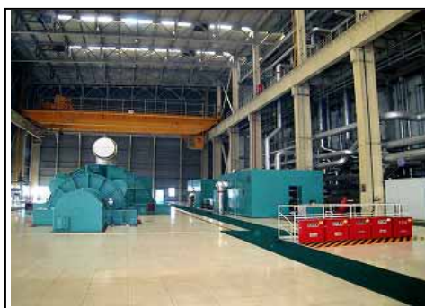
九江火力発電所第Ⅲ期内部
