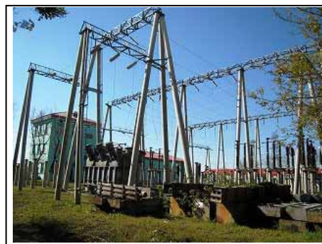
ハルビン市に建設された変電設備
