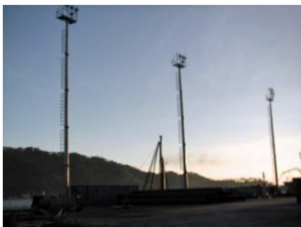
誘導用照明塔（ビトゥン港）
