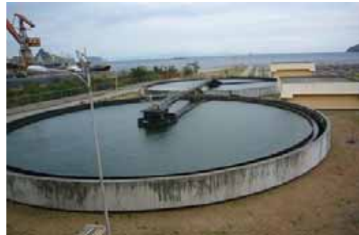
バターン特別経済区の排水処理施設
