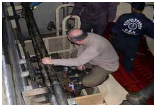
火災後の現場検証
