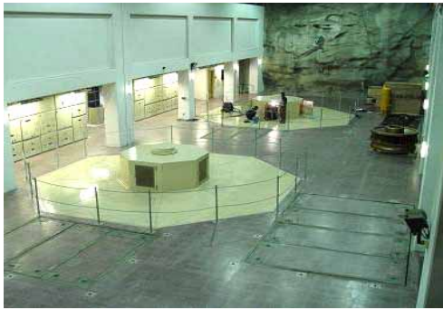
地下発電所最上階
