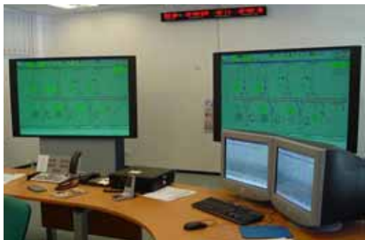
発電所制御コンソール（地上）
