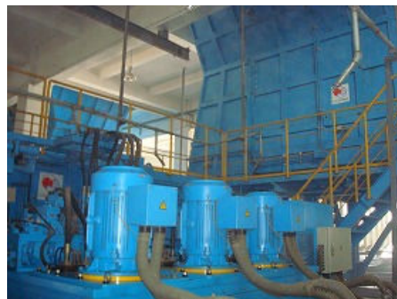
ごみの大型圧縮装置
