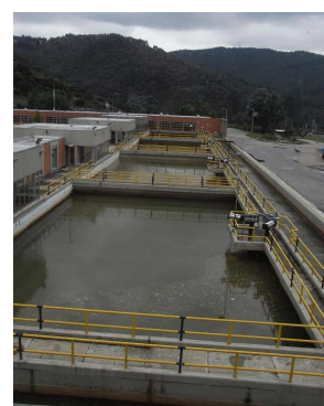
図 8 ウイスネル浄水場
