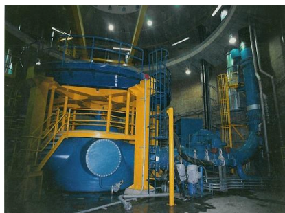
図 18 ポンプ場施設（最深部）
