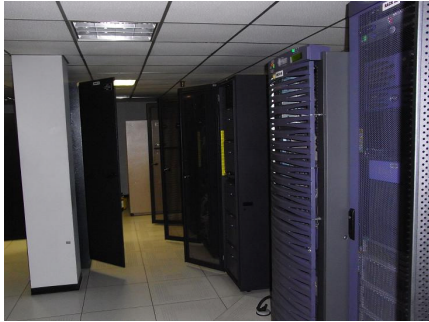
図 20 コントロールセンター内電算システム
