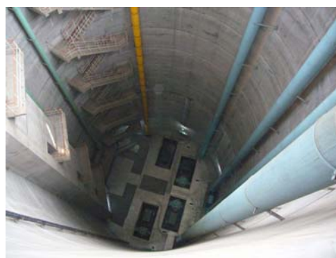
豊収壩浄水場内 着水井
