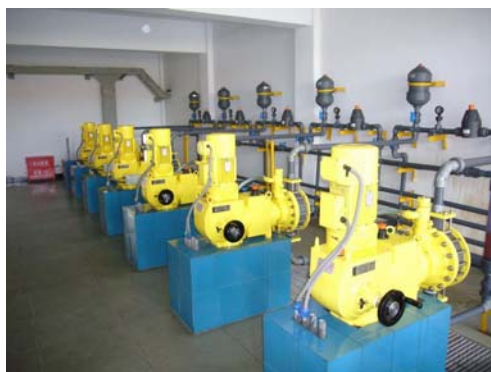
豊収壩浄水場内 塩素注入施設
